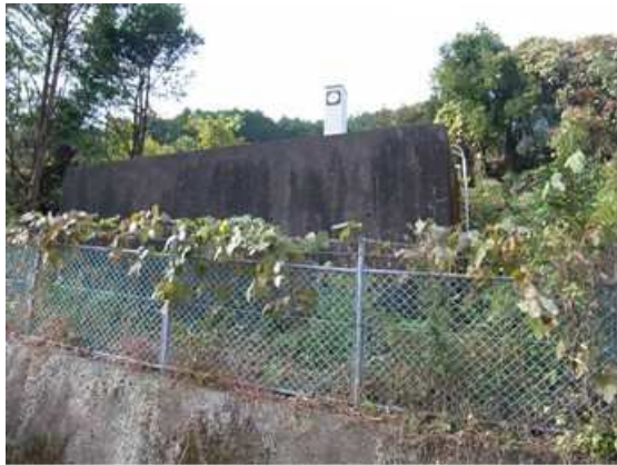
図表 2-11 本村簡易水道配水池
