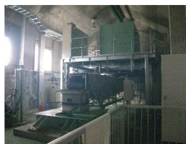
【管理棟内機械設備】
