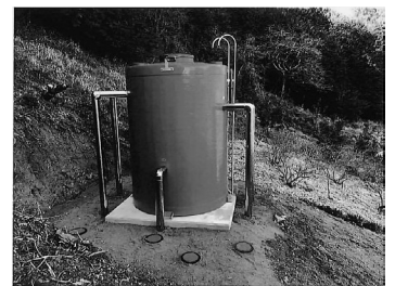
新設した緩速ろ過施設
