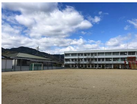
①外壁の落下、窓ガラスの割れはないか (校舎・柔道場)
