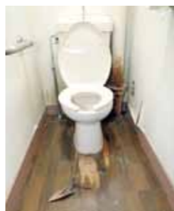
物件1 (床の剥がれ)
