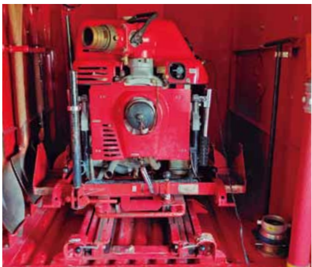
入れ替え予定の小型動力ポンプ
