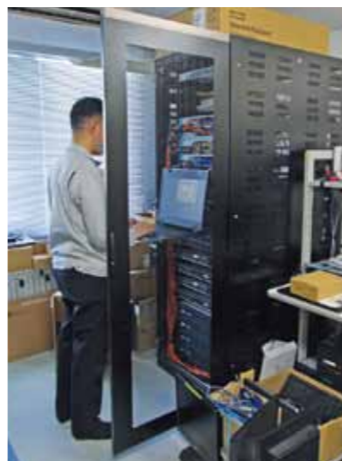
庁舎内電算室
