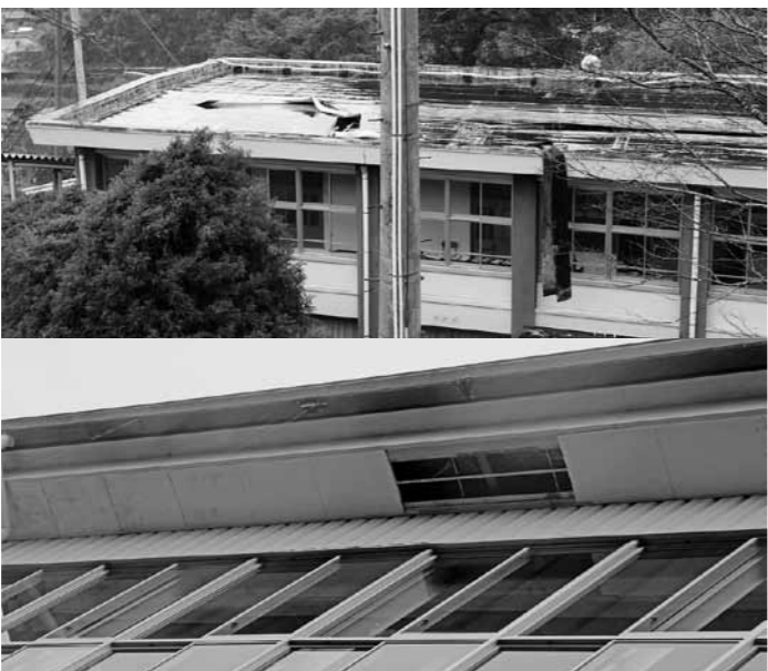
被害を受けた校舎屋上防水シート(上) 体育館の軒下の穴(下)
