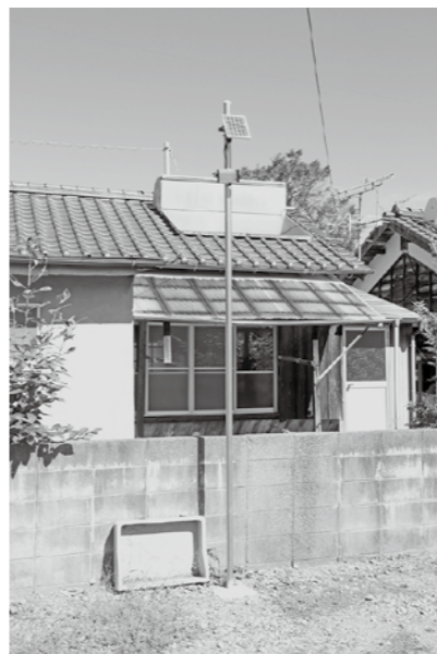
ソーラー式LED照明灯(鍋ヶ淵団地)
