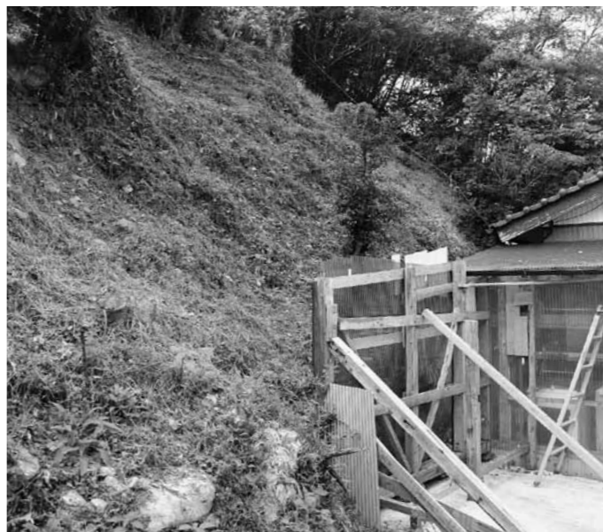
大雨などで裏山が危険な状態
