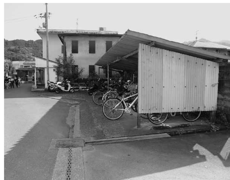
庁舎西駐輪場は支柱などが錆びている
