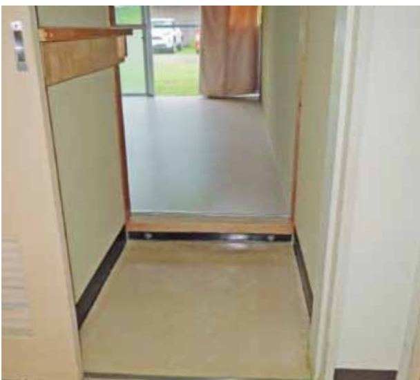
部屋の出入り口に段差がみられる（湖水園）
