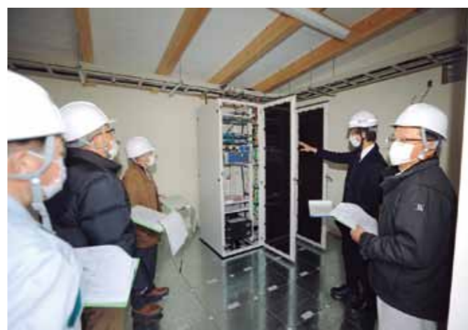
3区メインセンターの光回線設備
