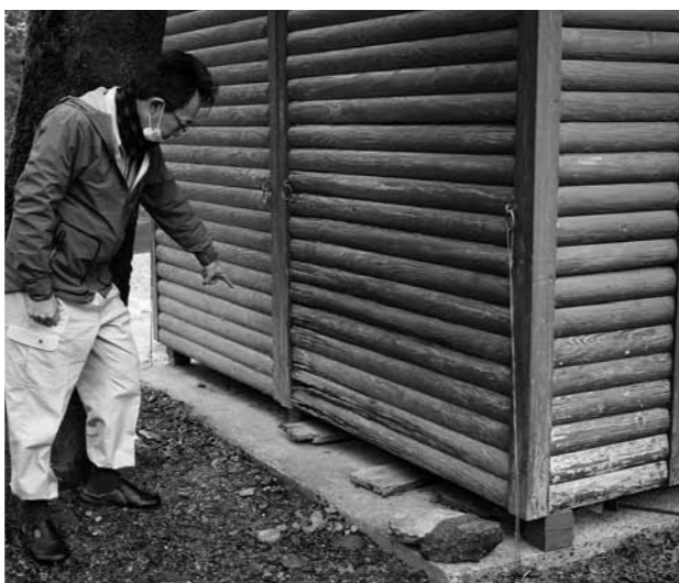
外壁の腐食が目立つ
