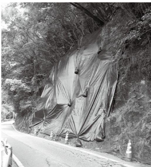
一時しのぎでビニールシート
