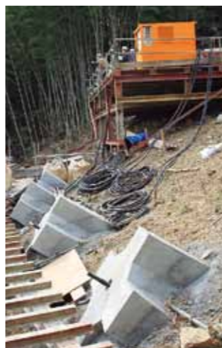
地すべりを止めるアンカーボルト（柚ノ木）
