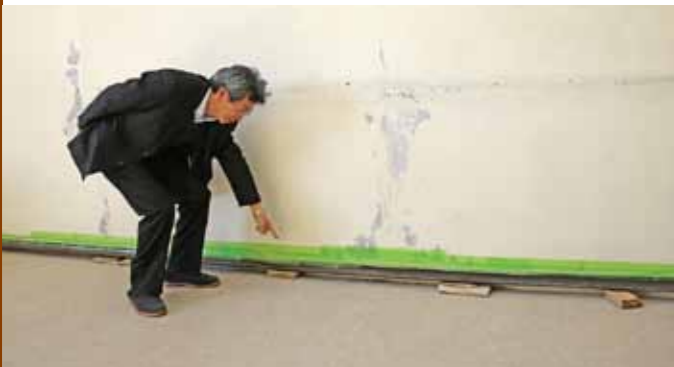
床に雨どいを置いて対応している給食通路
