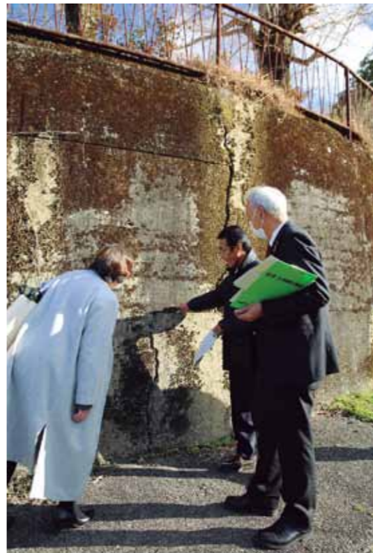
大きなクラックが見られる幼稚園運動場南側の擁壁
