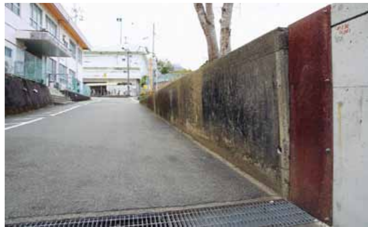
駐車場の擁壁に傾きとクラックが見られる(4区)
