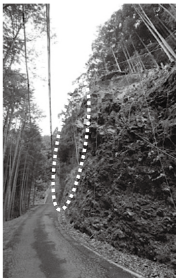
上側も崩落が見られ危険だ
