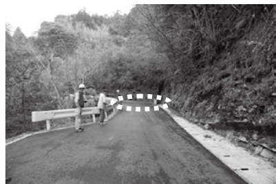
流末処理対策が必要な箇所
