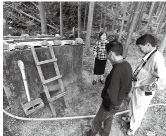
ろ過する砂が少なくなっている堂林地区のタンク
