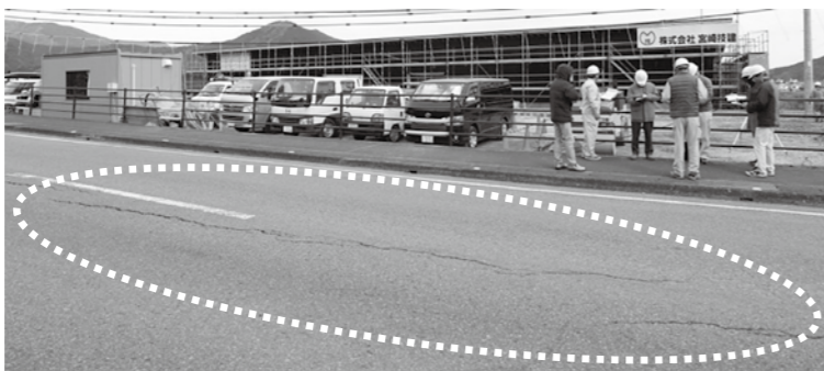
アスファルト舗装にクラックが見られる
