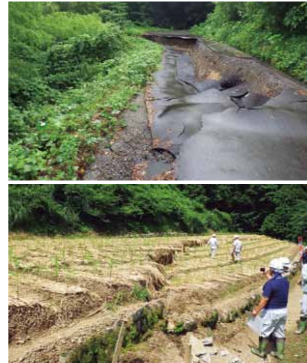
台風で被災した農道柚ノ木線（上段）、後山の農道日浦線（下段）
