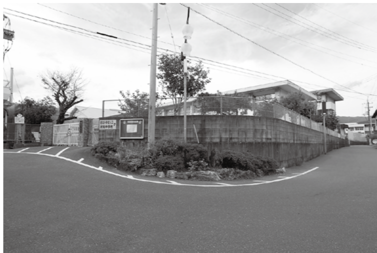
通学路にあるブロック塀
