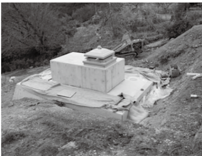
減圧水槽も数カ所に設置される（15区2）
