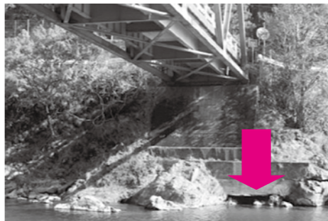
橋脚の下に大きな空洞ができています
