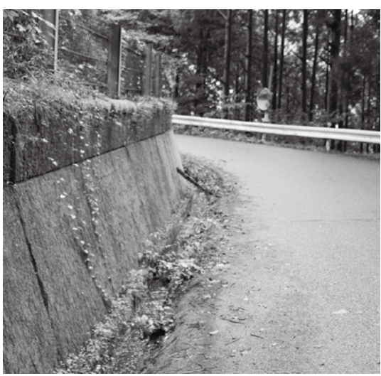
集落間では側溝と路面の段差が危険(本村～薬師堂)
