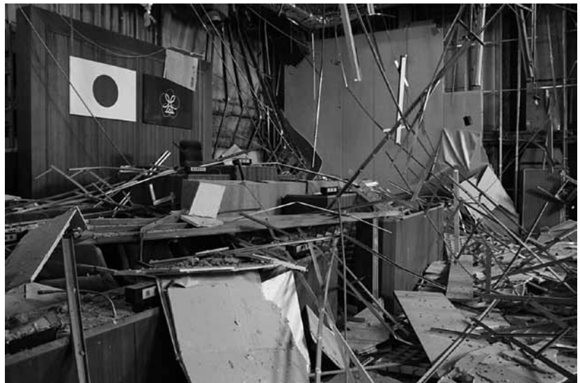
天井が落ち大きな被害を受けた議場
