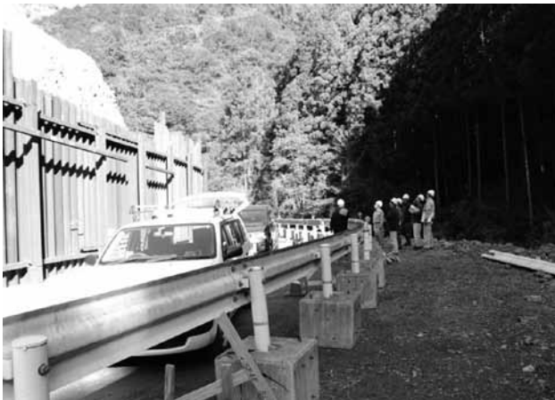
写真右の川側に残っている崩土を取り除いた時点で路側の被災も発見される可能性がある
