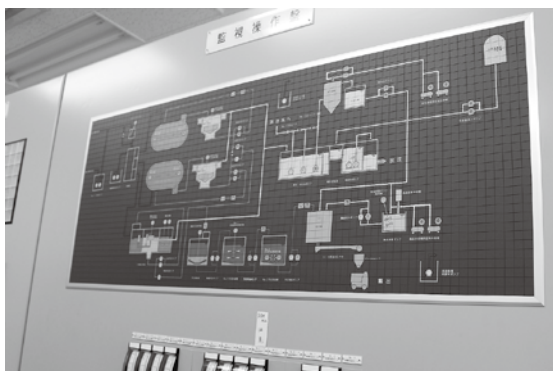
機能が充実した監視操作盤
