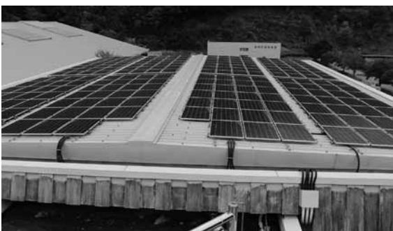
町民会館のホール屋根に設置している太陽光発電設備
