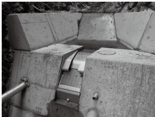
ウォータースクリーン設置により目詰まりしにくく安定した取水量を確保できる
