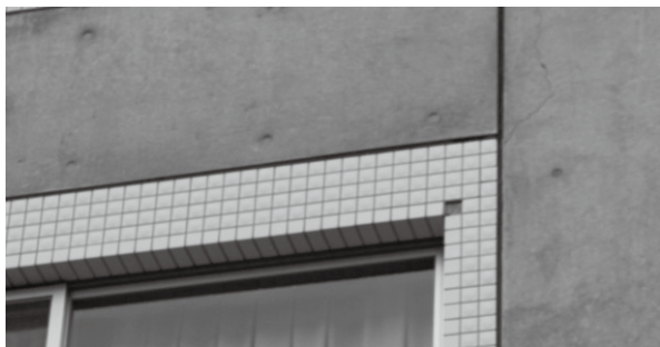
保健福祉センター南面のタイルが剥がれ落ちていた
