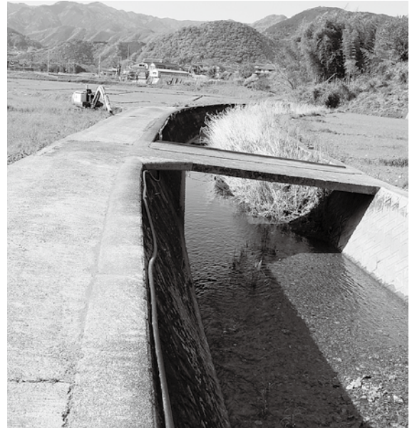
土砂が堆積した久万目川
