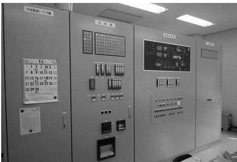
主要機器である配水処理の制御を行う盤(シーケンサ盤)が取り替えられる
