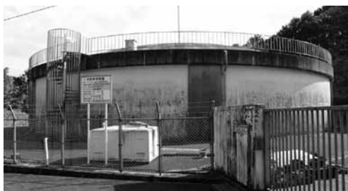
4000人以上に水を供給する上水道貯水池
