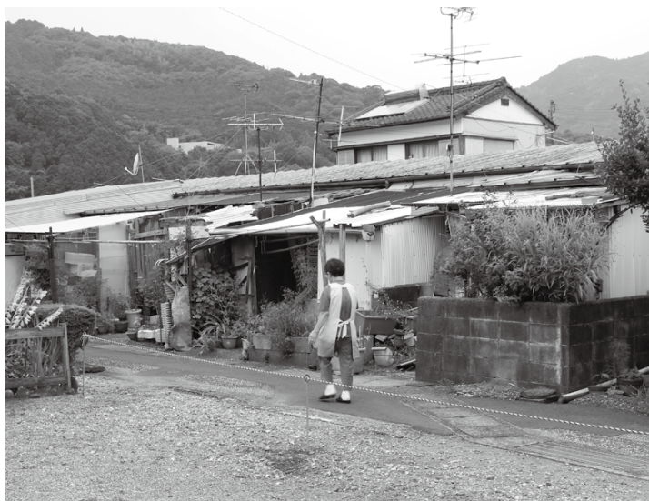
雨漏りがしている9区西ノ芝住宅
