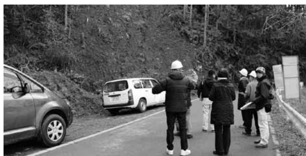
崩落したままの現場
