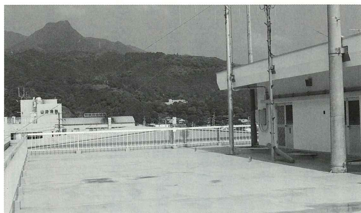
太陽光発電・蓄電池が設置される役場屋上
