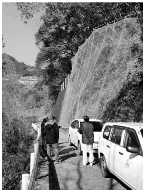
落石対策で安全な道路に
