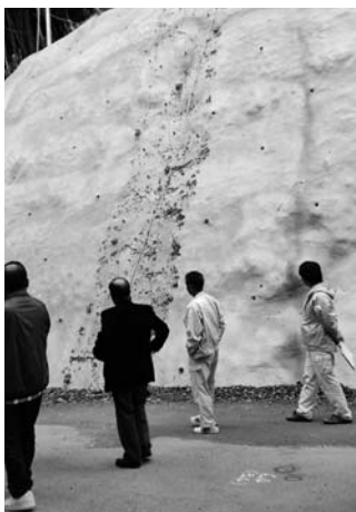
モルタルの亀裂に注意が必要
