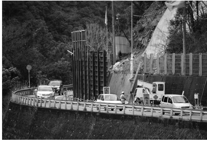
昨年8月の巨岩崩落から片側交互通行で復旧されている国道33号
